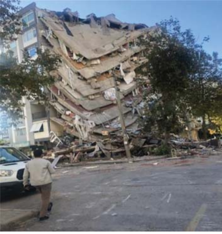
Şekil 5 - Planda kısmi göçme görülen bir yapı
