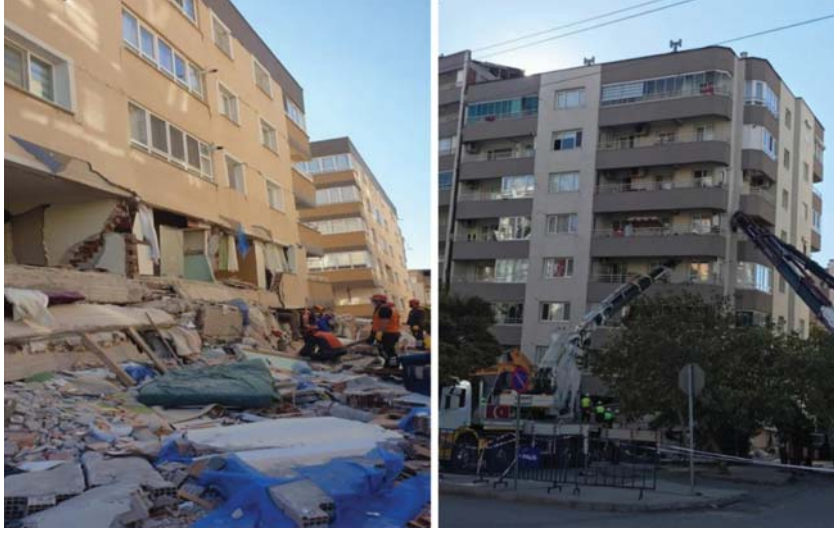
Şekil 4 - Alt katlarda göçme görülen bazı binalar
