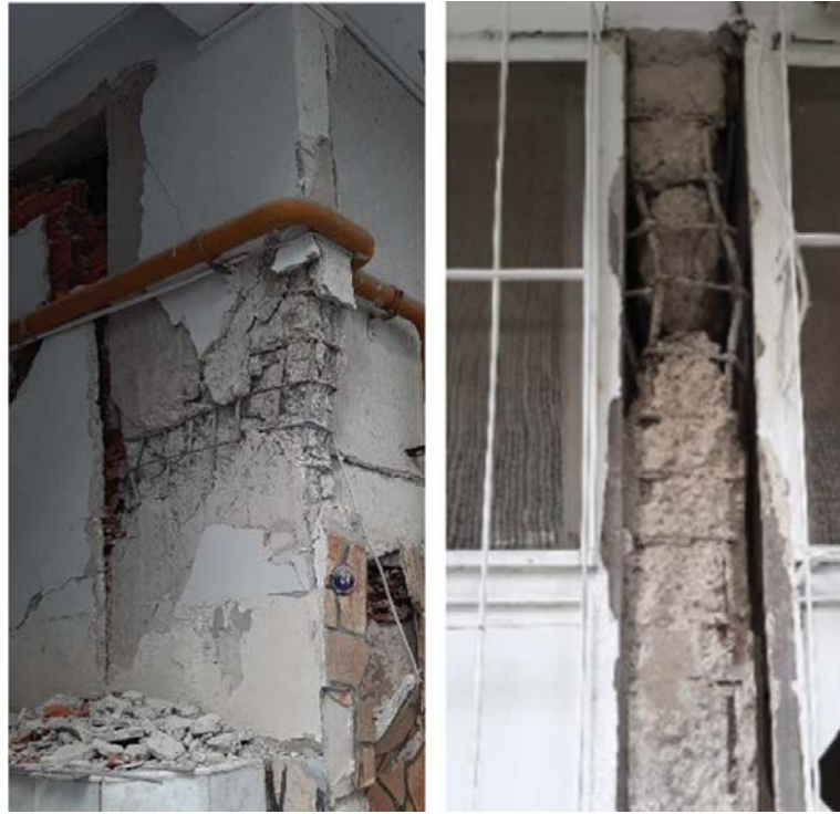
Şekil 14 - Kolon ve perdelerde gelişen hasarlar
